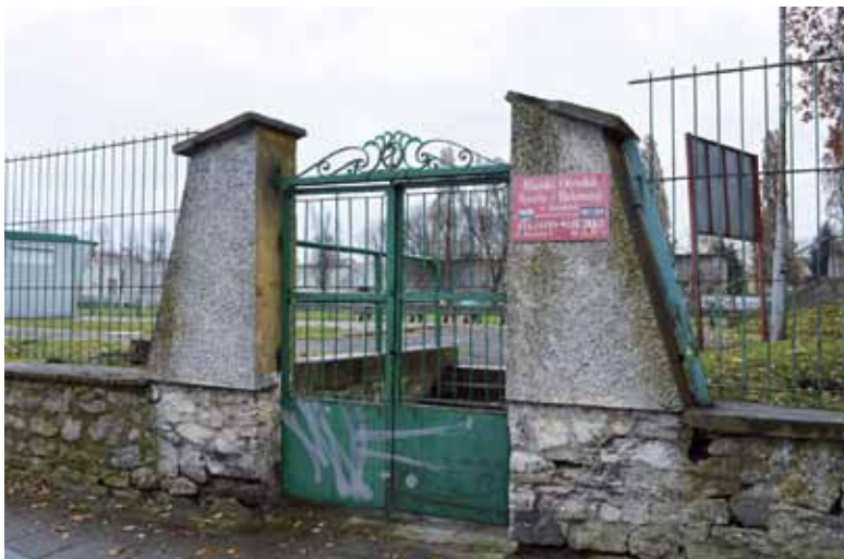
Stadion wymaga pilnego remontu.
